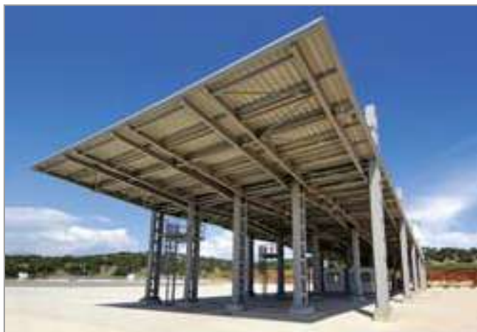
Πύλη εισόδου λιμανιού ΝΑ.ΒΙ.ΠΕ (Κ/Ξ Αστακός Τέρμιναλ)
